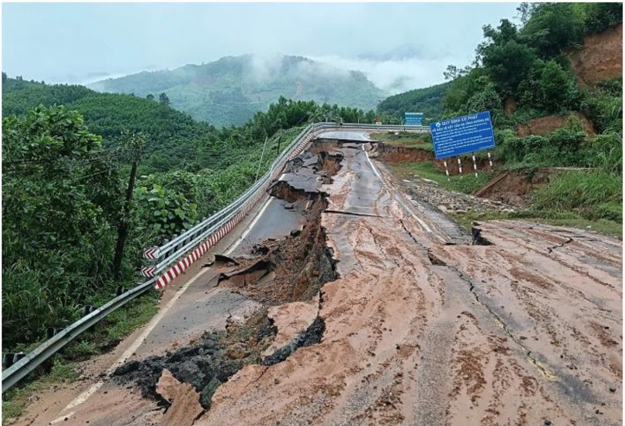
Nhiều tuyến đường giao thông bị sạt lở nghiêm trọng do mưa lũ, hình ảnh hiện trường sạt lở trên đèo Khánh Lê, tỉnh Khánh Hòa đã khiến 6 người chết, 16 người bị thương Nguồn ảnh: Báo Điện tử Chính phủ.
