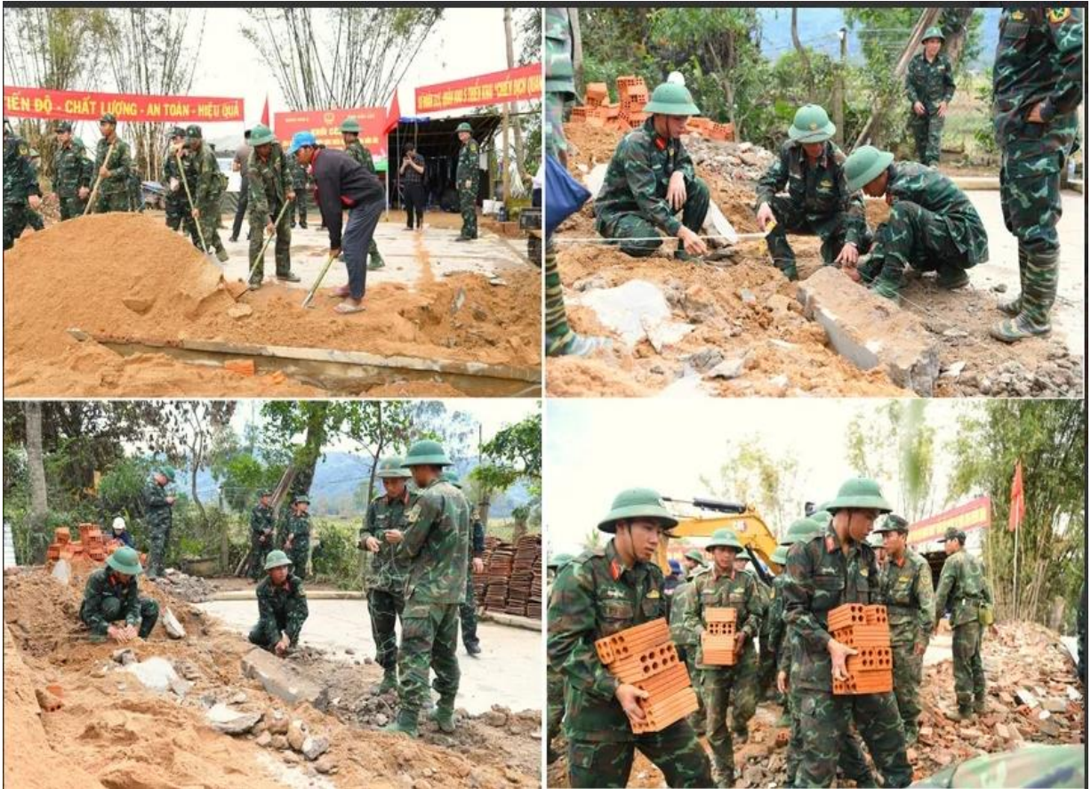
Bộ Quốc phòng huy động các lực lượng quân đội hỗ trợ xây dựng lại nhà cho nhân dân vùng bị bão, mưa, lũ gây ra tại khu vực Miền Trung - Nguồn ảnh: Báo Điện tử Chính phủ.
