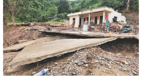
Trụ sở Công an xã Mỹ Lý hoang tàn sau lũ dữ
