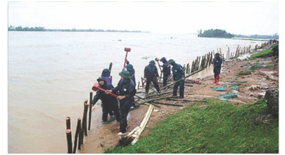
Các lực lượng hộ đê đang xử lý, khắc phục sự cố sạt trượt mái đê tại phường Quảng Phú
