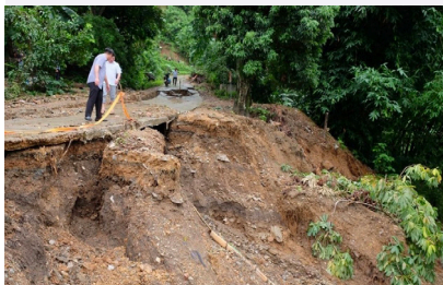
Một tuyến đường thuộc huyện Bảo Lạc (Cao Bằng) bị sạt lở, gây nguy hiểm cho người và phương tiện lưu thông trên đường.
