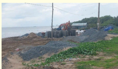
Khu vực sạt lở bờ biển tại xã Trường Long Hòa, thị xã Duyên Hải, tỉnh Trà Vinh
