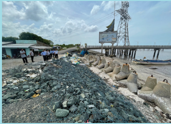
Hình ảnh sạt lở bờ biển Vĩnh Trạch Đông, tỉnh Bạc Liêu
