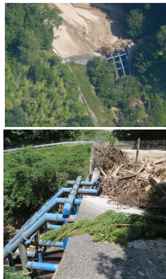
Đập Sabo ngăn lũ bùn đá và gỗ trôi
