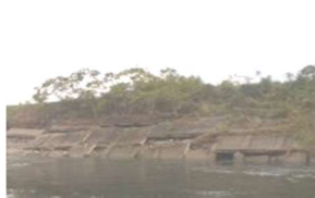
Xói mòn lòng sông và bờ sông
