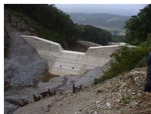
đập sabo kín
